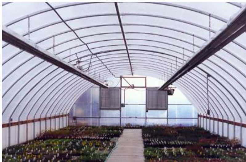
Εικόνα 2-c: Gas-Fired Infrared Heating system
