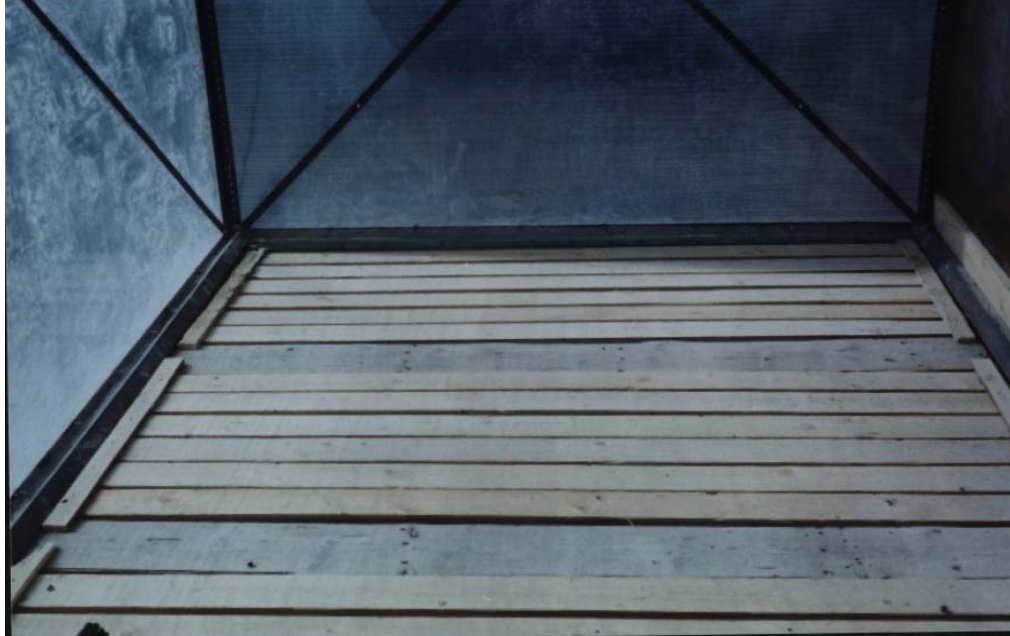
Φ.5.2. Βάση χώρου ξήρανσης και ισοδιανομή αέρα.
